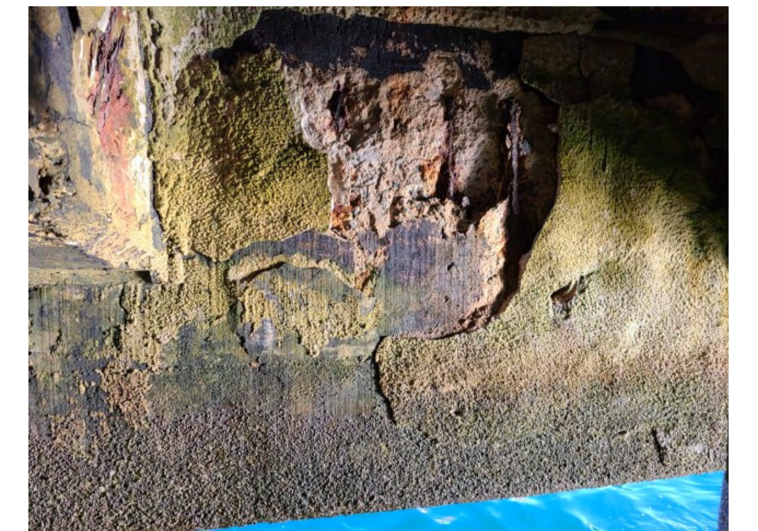
Photo 7 - Headstock Spall N.T.S.
